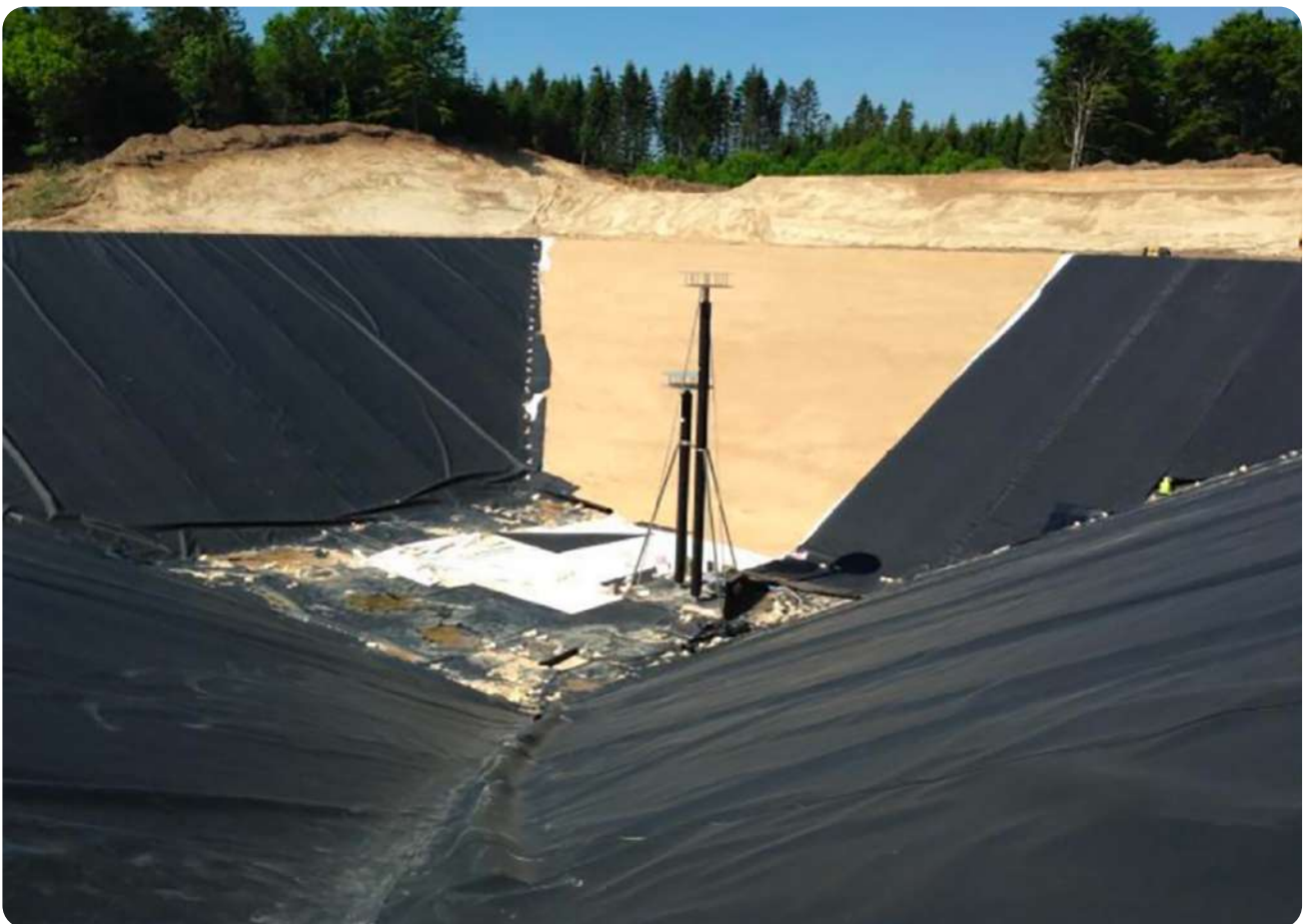
Rysunek 4-2 Układ wlotu/wylotu przez spód magazynu. Trzy rury zakończone dyfuzorem u góry, na dole i na środku objętości magazynu. Zdjęcie z realizacji magazynu w Dronninglund. Źródło: Final report SUNSTORE 3, Phase 2, Implementation
