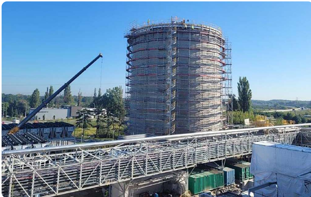
Rysunek 2-10 Magazyn ciepła na terenie EC Czechnica-2 (fot. PGE Energia Ciepła).
